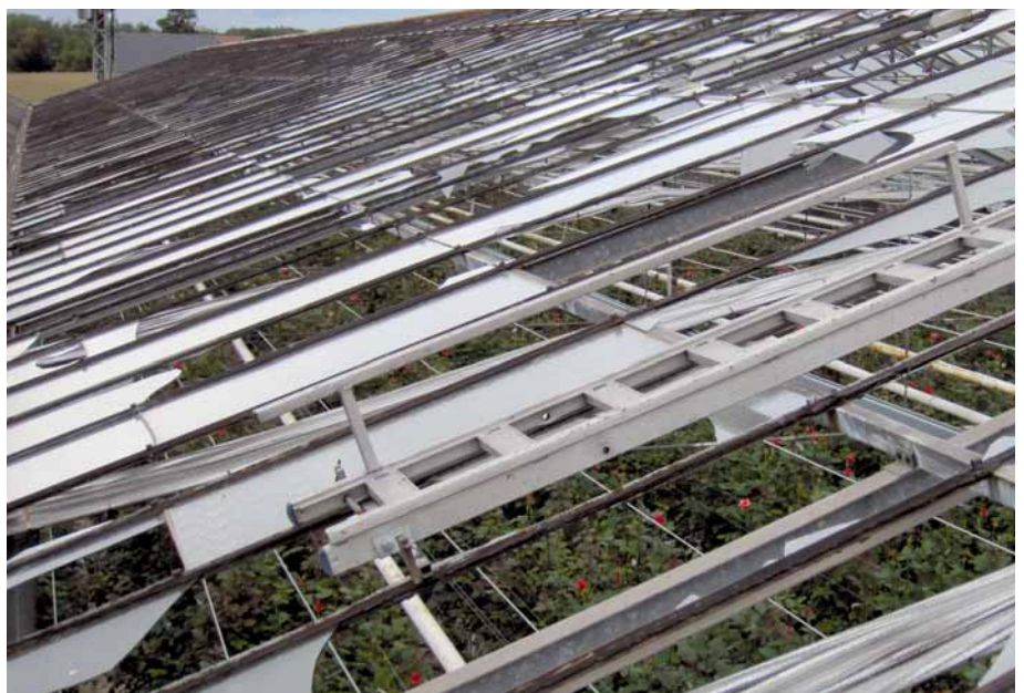
Hagel verwüstete am 26. August einen beachtlichen Teil einer Gärtnersiedlung im Münsterland. Durch die sehr festen, scharfkantigen Hagelkörner kam es insbesondere an den Schlagseiten der betroffenen Gewächshausanlagen zu Totalschäden.
