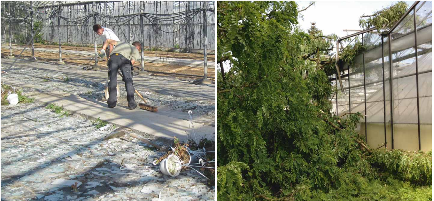
Am Pfingstmontag, den 9. Juni zog eine schwere Gewitterfront von Frankreich kommend über den Beneluxraum und Deutschland hinweg. Während das Unwetter in Frankreich große Schäden durch Hagel anrichtete (Bild li.), war Deutschland vor allem von starken Orkanböen betroffen. Zahlreiche Bäume wurden entwurzelt und hinterließen auch im Gartenbau ein Bild der Verwüstung. (Bild re.)
